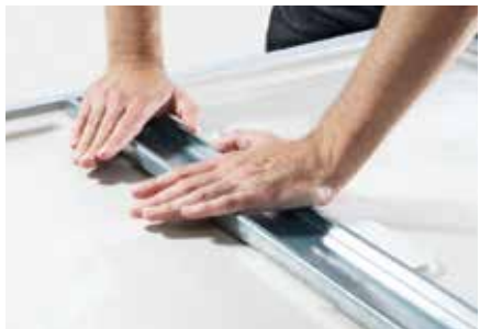
PROFIEL OP DE DOUCHEVLOER PLAATSEN Na het verwijderen van de beschermingsfolie wordt het profiel op de douchevloer geplakt.
